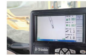
コントロールボックス
